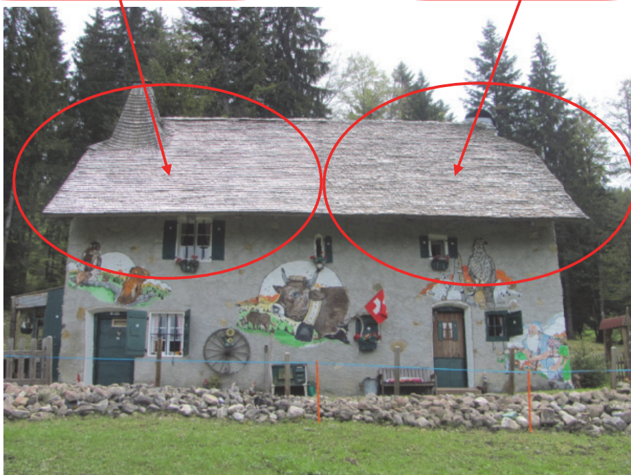
Pan nord de la toiture qui montre la moitié restaurée et l'autre dégradée
